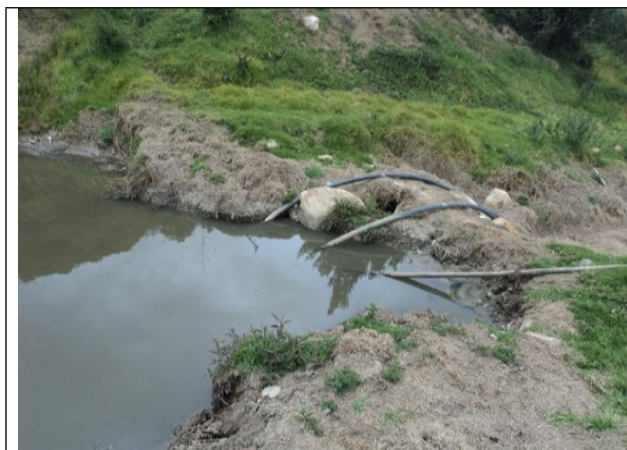
Foto No. 3. Punto de captación. Mangueras sumergidas.
